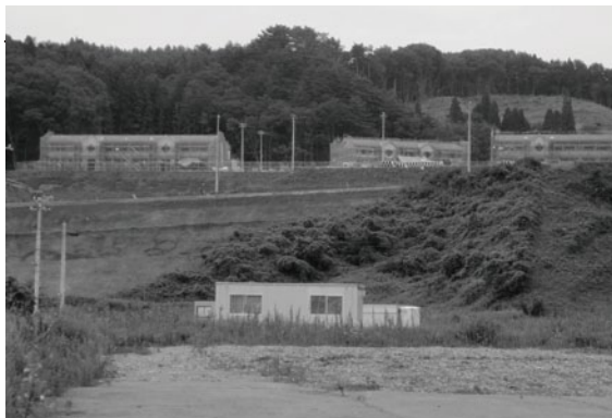
観光ホテルの奥の高台を切り崩して、災害公営住宅を建設中。 一部は11月頃に入居開始とのこと。2015年8月30日
