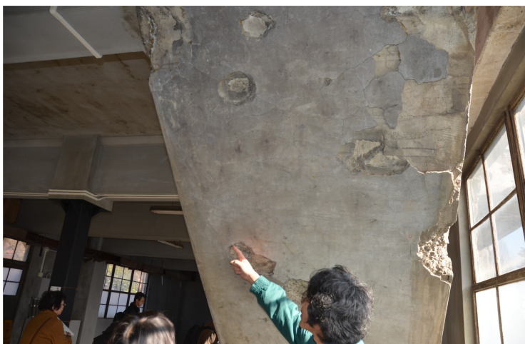
東大和市の戦災建造物「日立航空機変電所」(M)、建物内の銃撃痕。 中田均氏提供
